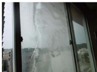
割れている窓
