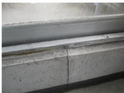
窓廻りの老朽化と 窓下のひび割れ
