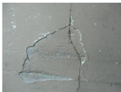
内壁ひび割れ
